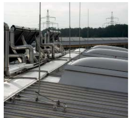
Bild 1.1.4.7 Fangstange für Lichtkuppel auf Rundstehfalz-Dach
